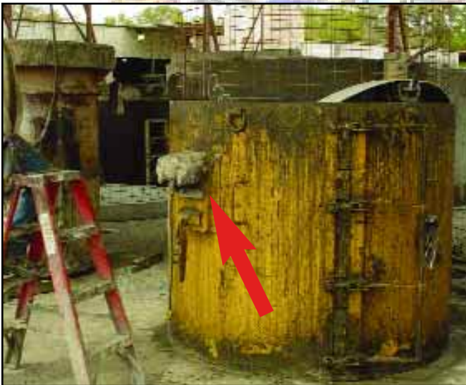
US-1600 on manhole
